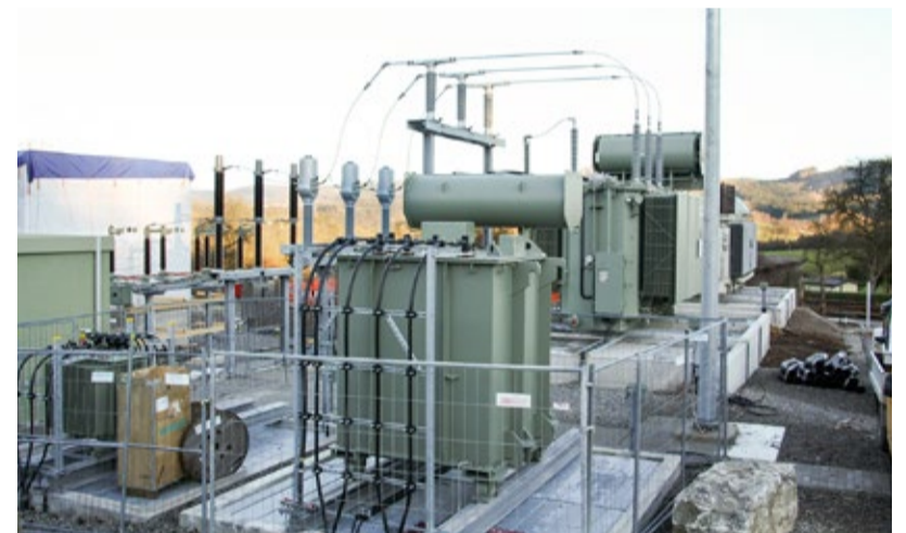
Moderne Technik für mehr Versorgungssicherheit.
