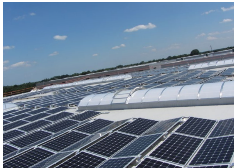
PV-Anlage auf dem Multipark an der B471.
