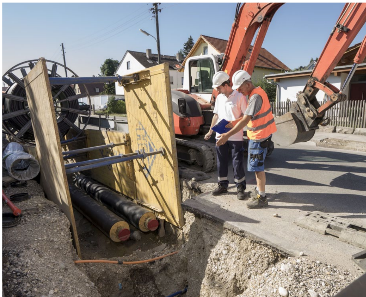
Die Stadtwerke Olching setzen auf Fernwärme!
