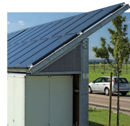
Die Fotovoltaikanlage auf dem Lärmschutzwall im Industriegebiet Solpark.
