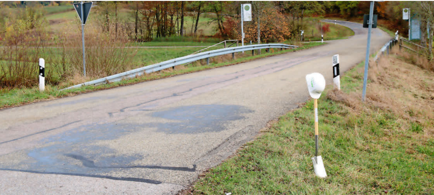
Für die Breitbanderschließung nach Wielandsweiler und Sittenhardt sind teilweise Eingriffe in öffentliche Straßen vonnöten.
