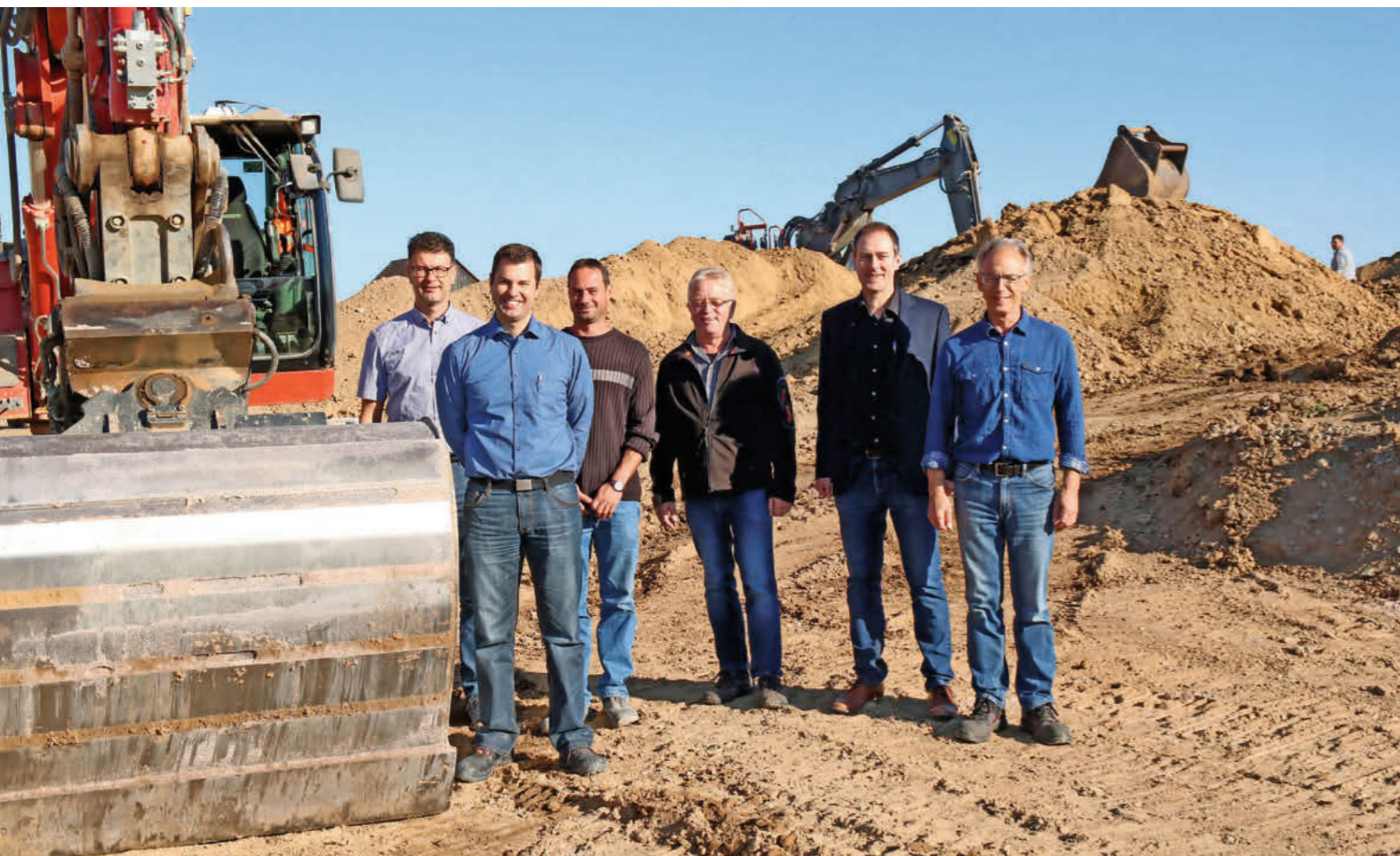
Im Frühjahr und in den Sommermonaten ist das Team Planung Netze direkt auf den Baustellen und begleitet die Baumaßnahmen. Außerdem sind die Teammitglieder Ansprechpartner für alle Beteiligten.
