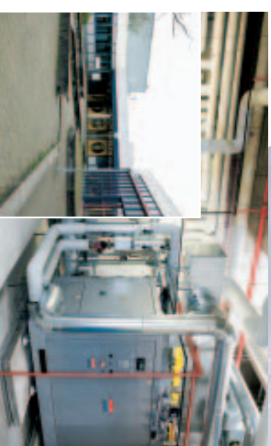
Schulzentrum West: Übernahme und Betrieb der Heizzentrale sowie Installation eines Blockheizkraftwerkes mit 240 kW elektrischer Leistung zur Versorgung des Schulkomplexes und einem Nahwärmernetz für angrenzende Wohngebäude.
