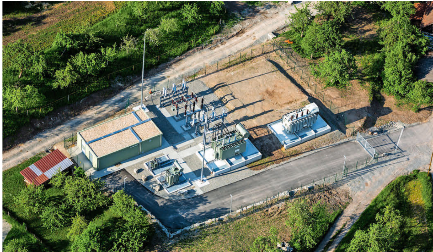
Das Team Hochspannung der Abteilung Netze ist für den Betrieb der Umspannwerke im Netzgebiet zuständig. Hier zu sehen ist das Umspannwerk in Rosengarten-Westheim.
