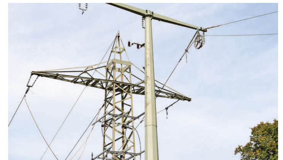
Die elektrotechnischen Fachleute der Abteilung kümmern sich auch um Freileitungen sowie Strommasten.
